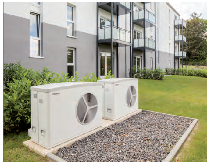
Wärmepumpen können zur Beheizung von Mehrfamilienhäusern auch als Kaskade in Reihe geschaltet werden.
