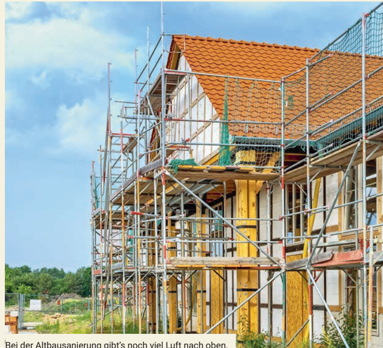
Bei der Altbausanierung gibt's noch viel Luft nach oben.
