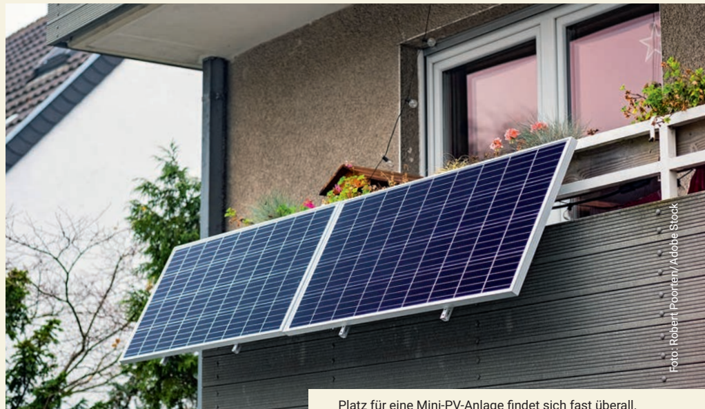
Platz für eine Mini-PV-Anlage findet sich fast überall.
